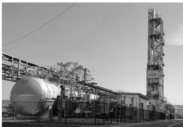
写真2 二酸化炭素分離回収装置
