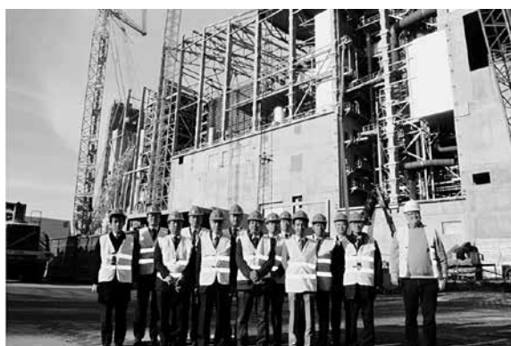
コペンハーゲンのアマーごみ焼却施設 (建設中の新施設)
