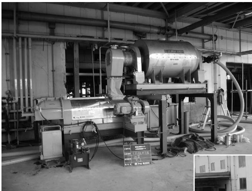
写真 4 仮設前処理設備
