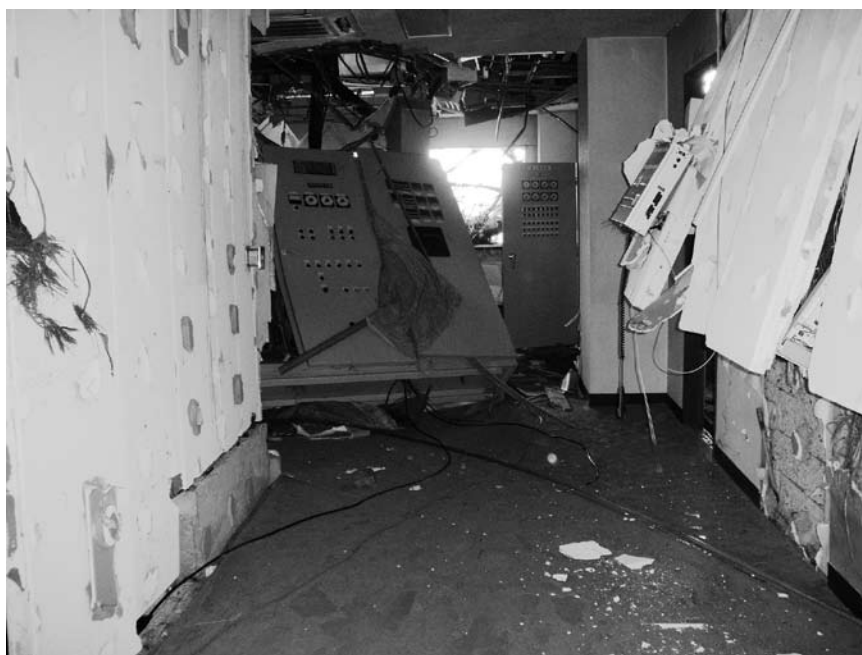
写真3 地震後、津波を受け、損壊した建物内部
