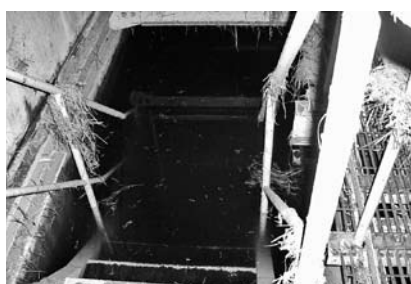
写真4 浸水した地階部分
