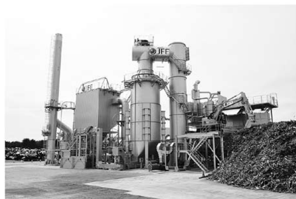
写真 1 プラント外観
