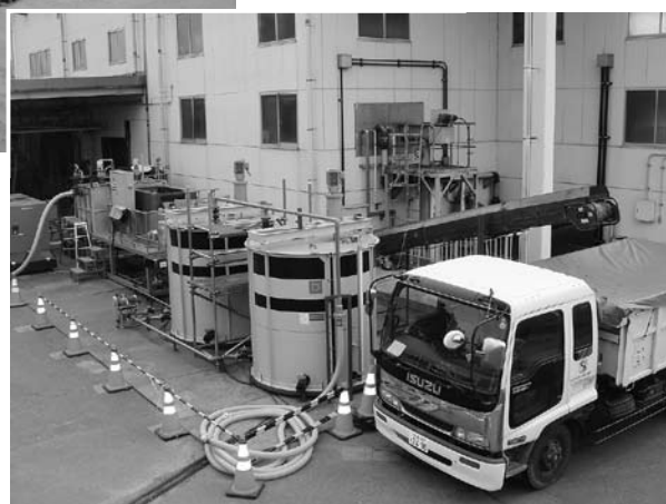
写真 5 仮設脱水設備
