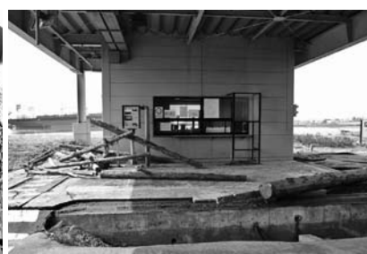
写真5 津波被害を受けた ごみ計量器
