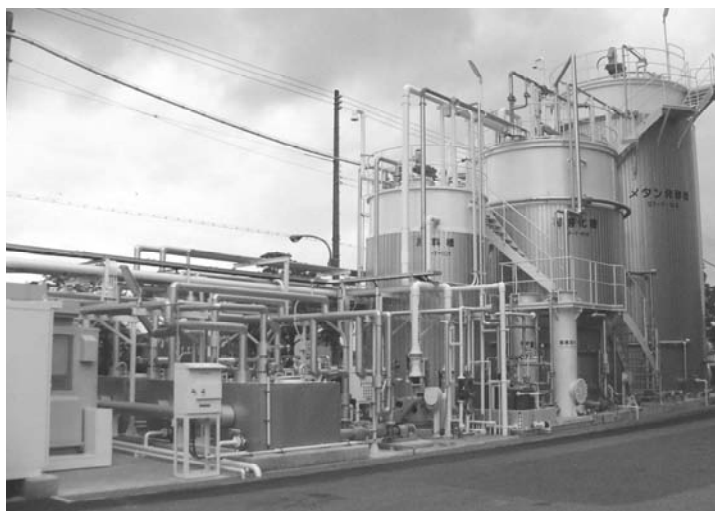
図2 コープこうべ殿向けメタン発酵設備 全景
