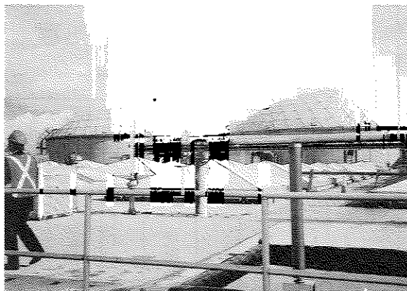
写真3 トリックリングフィルター設置タンク
